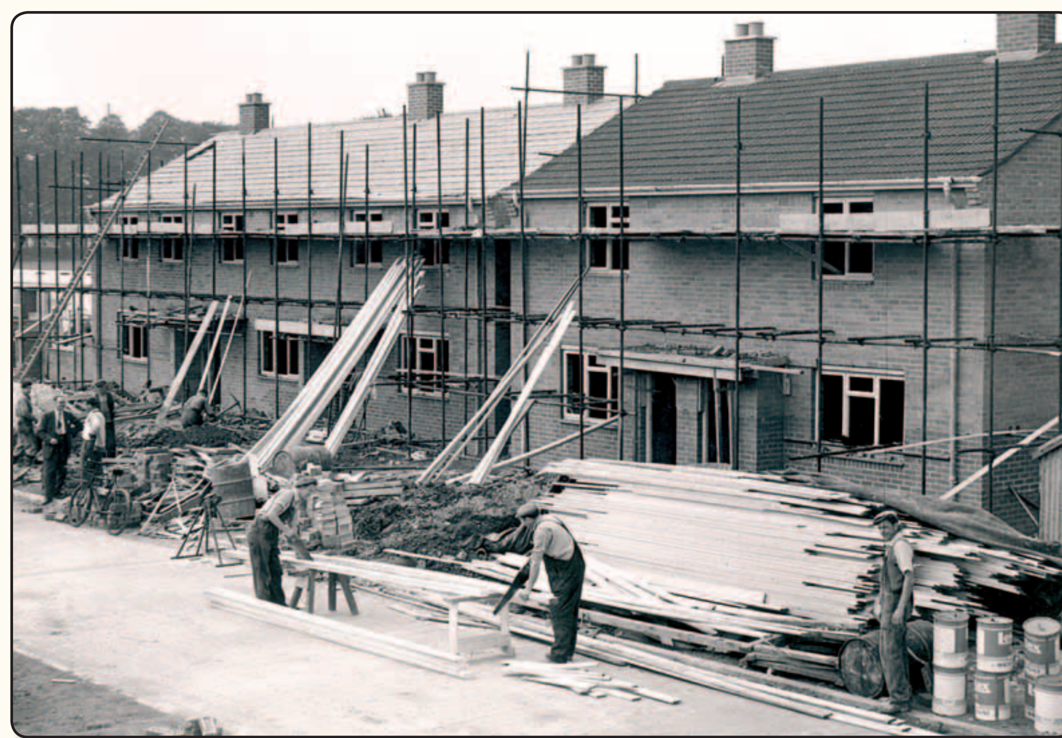
Builders at work on new council houses on Ashfield Road. Adeiladwyr yn gweithio ar dai cyngor newydd ar Ffordd Ashfield.
